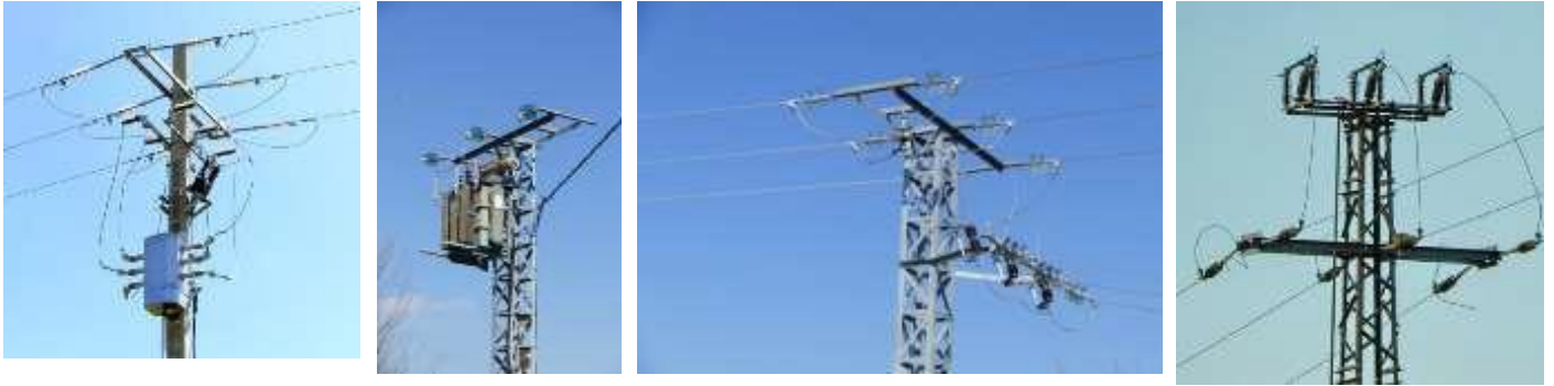
图片 1：输电线路的危险设备实例（照片：J. Martin Martin & A. Camiña）。
